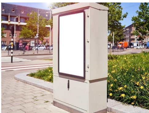
電力、ネットワークステーション
